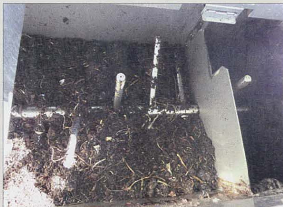
大型電動生ごみ処理機内部
